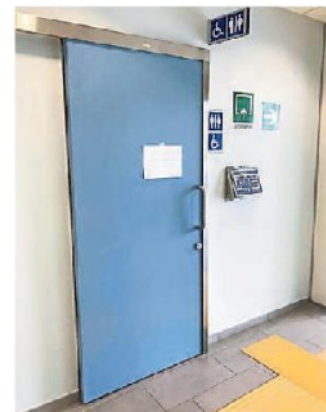
Uno dei bagni vandalizzati
