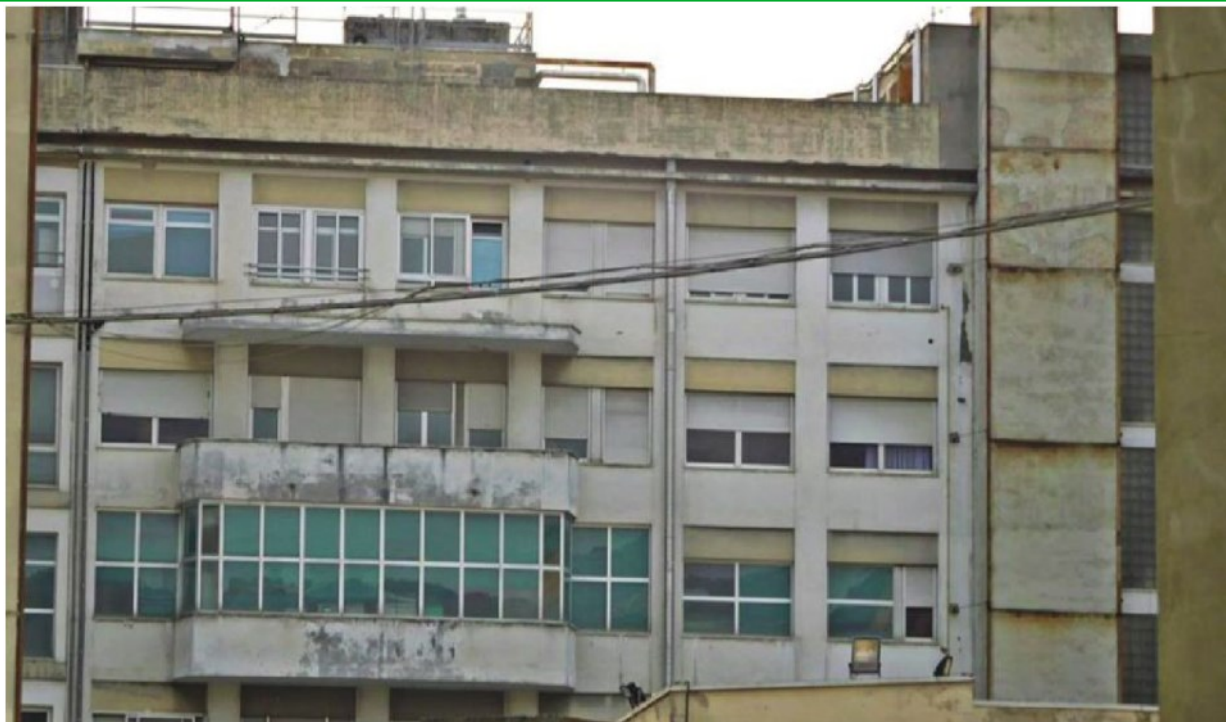
STRUTTURA FATISCENTE L'Ex-Misericordia e Dolce di Prato che versa in una situazione di degrado.
