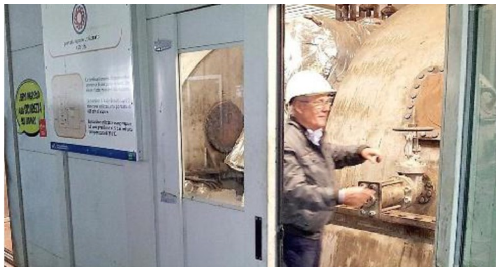
IL CUORE DELLA CENTRALE Un impianto geotermico durante una visita aperta al pubblico
