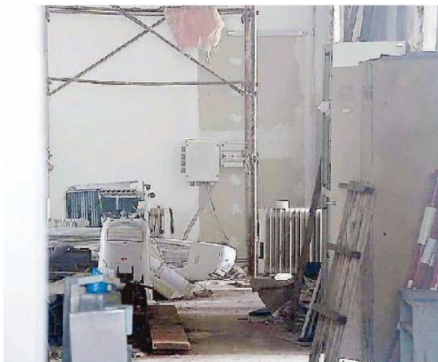
Il degrado nella palazzina abbandonata
