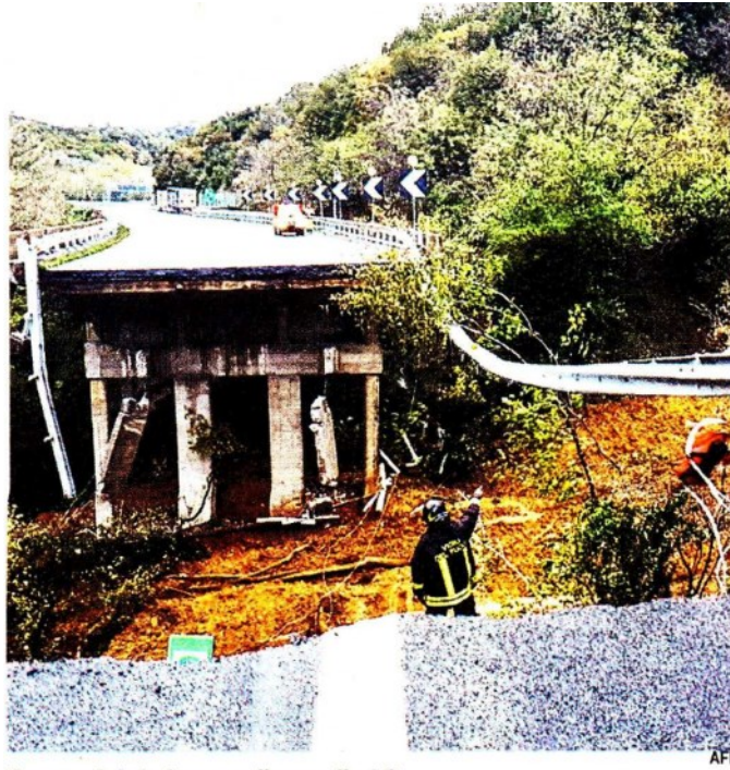
Il tratto del viadotto crollato sulla A6
