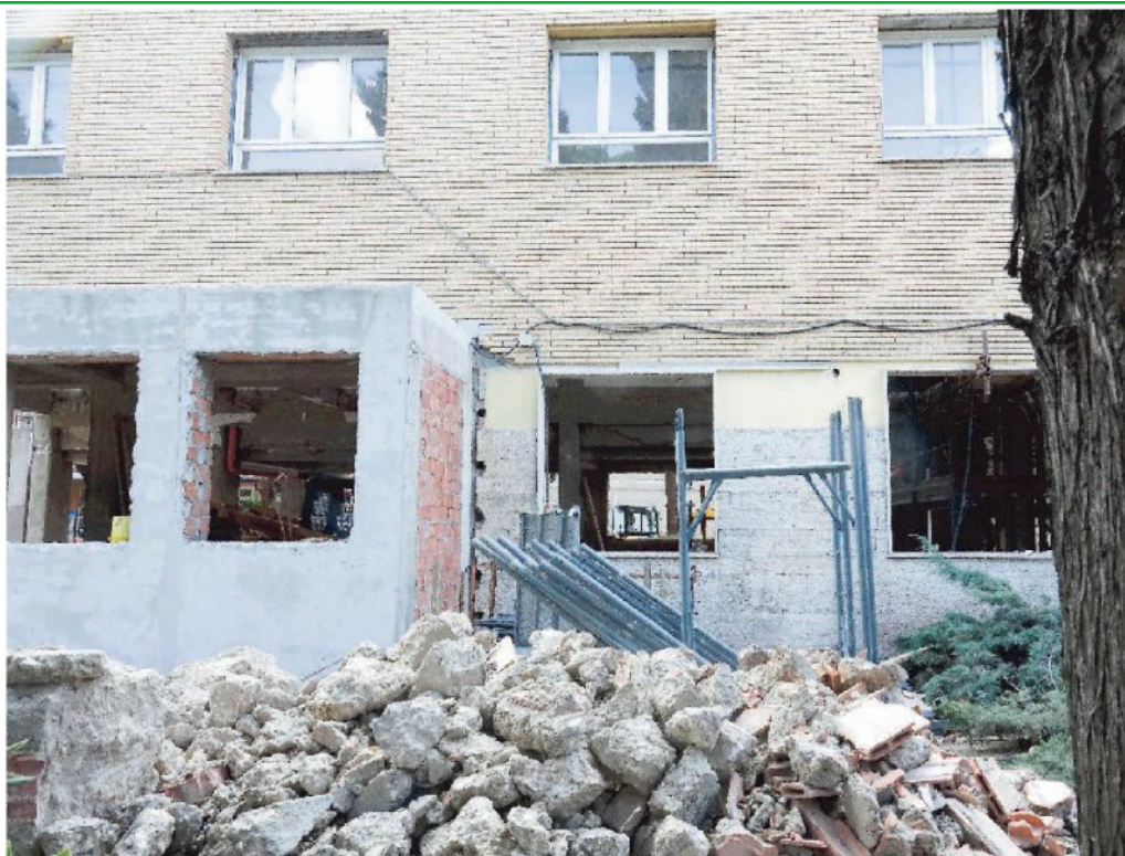
Il cantiere al distretto sanitario di via del Mare fermo da due mesi: l'edificio dovrà essere abbattuto
