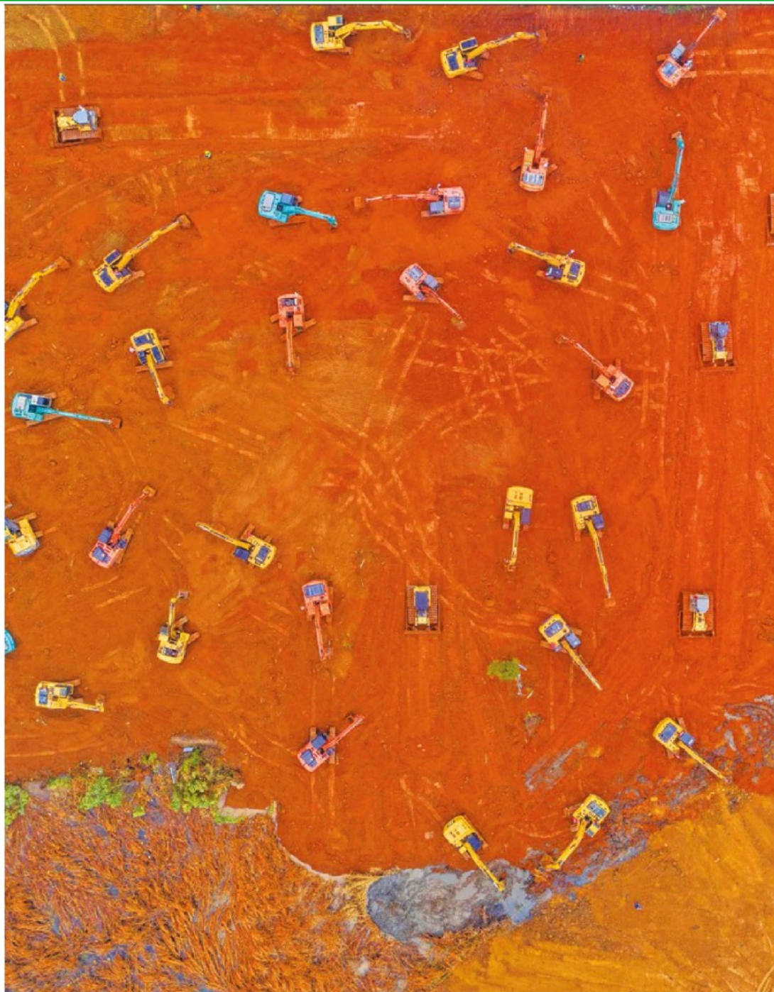
Attacco al virus. Decine di ruspe schierate nel maxi cantiere del nuovo ospedale di Wuhan
